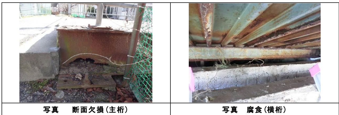
図表 主桁、横桁の劣化状況の例
