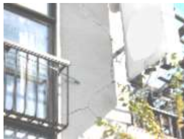
取付け壁面のひび
