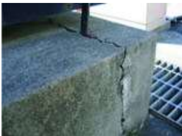
看板基礎部分のひび割れ
