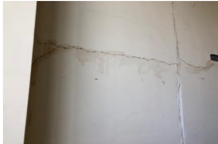
【青年の家内壁のクラック】
