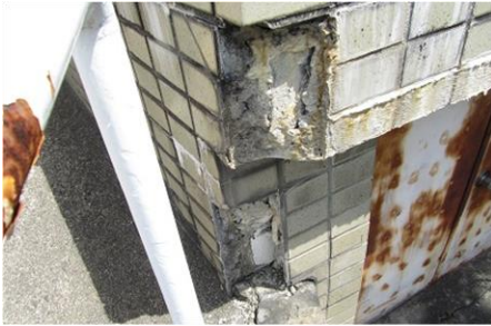
【本庁舎外壁の欠損】
