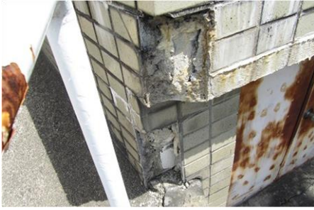
【本庁舎外壁の欠損】
