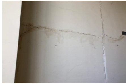
【青年の家内壁のクラック】
