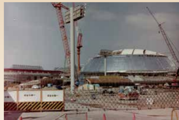
建設中のいきいきランド交野(1997年) 建設時から市民の目を引いていました
