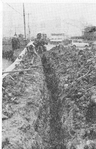
倉治郡津線 (2中附近)
