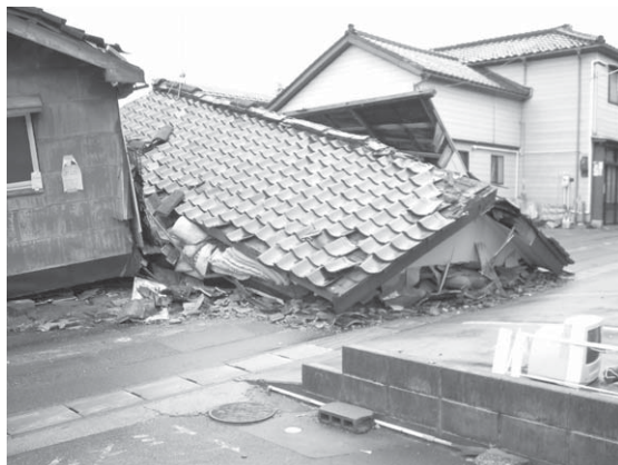
地震で倒壊した家屋
