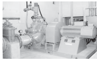
小水力発電設備
