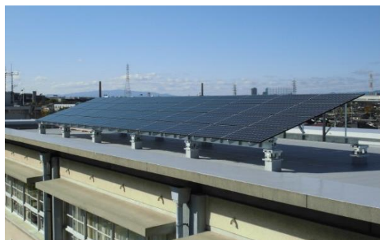
第四中学校に設置された太陽光パネル
