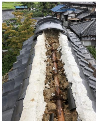
台風による毀損（山添家住宅）
