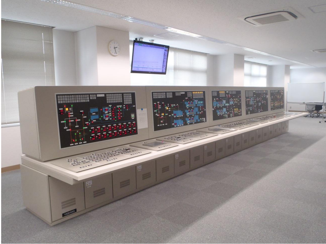
中央操作監視室
