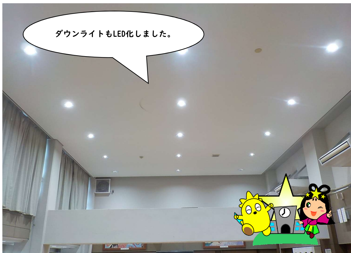
校舎棟照明器具LED化完成 (写真は星田小)
