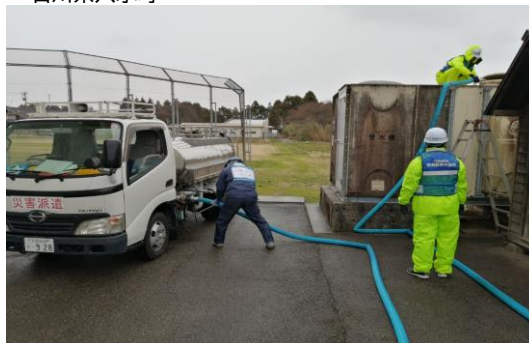
石川県穴水町
