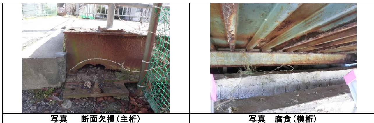
図表 主桁、横桁の劣化状況の例
