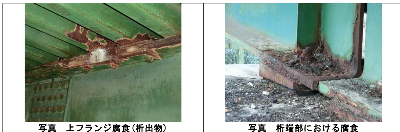
図表 主桁の劣化状況の例
